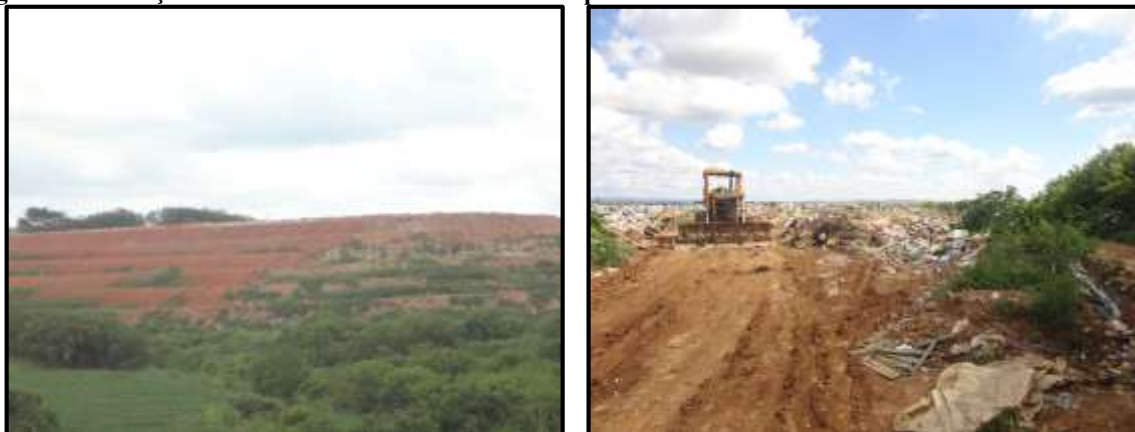
Figura 19. Situação atual do aterro controlado municipal
