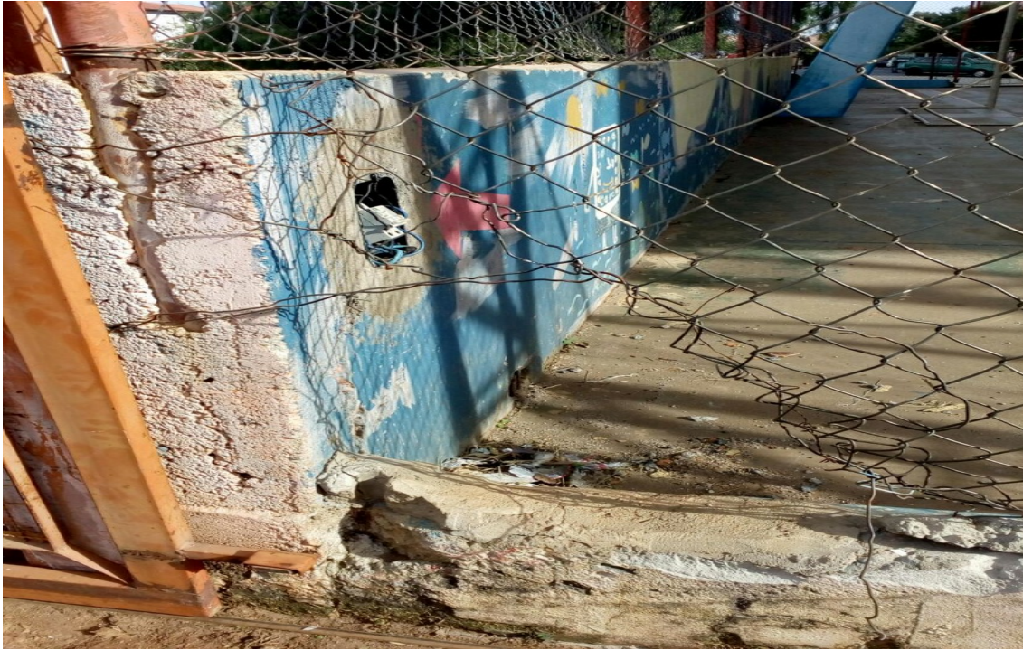
Caixa de Energia com os fios elétricos expostos.
