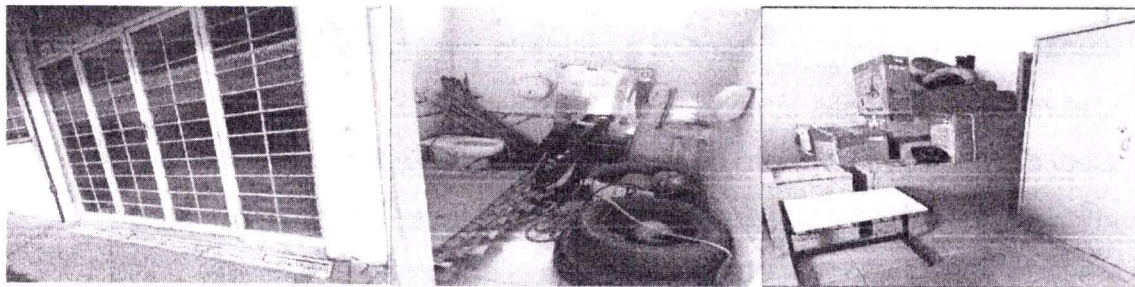
Vidros quebrados, materiais guardados no banheiro e materiais em desuso.
