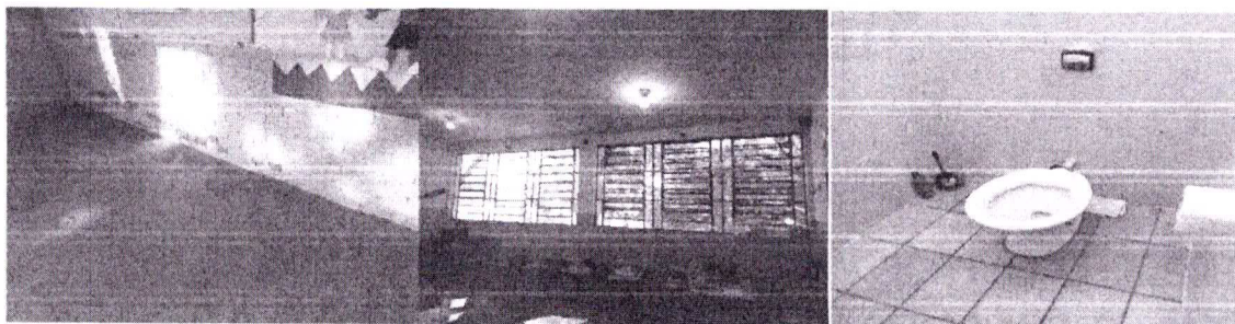
Paredes descascadas, janelas sem cortinas e vaso sanitário sem tampas.
