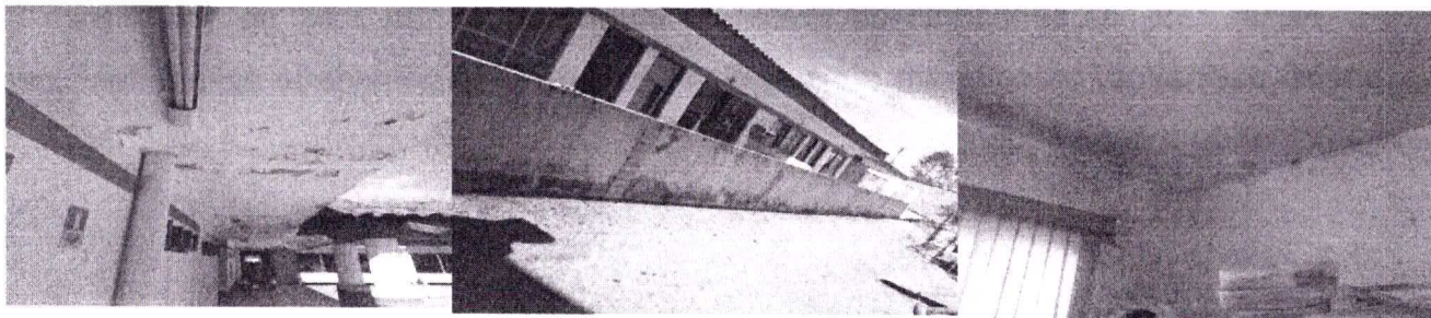
Laje e paredes descascadas e com falhas na pintura e infiltração, umidade e mofo no teto.
