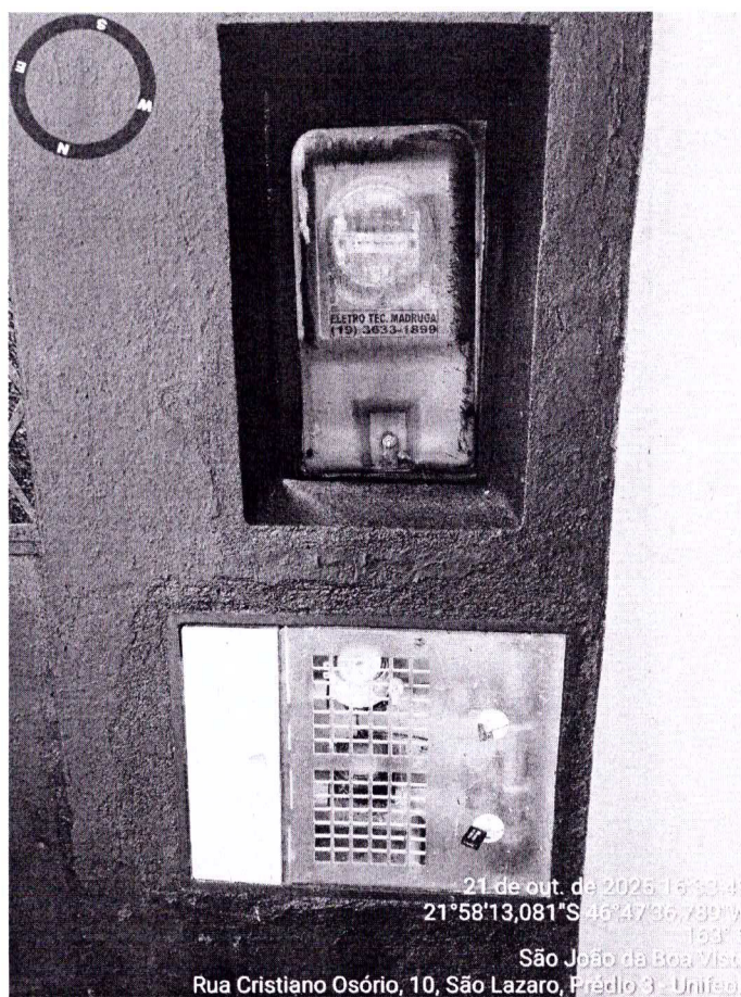
22 - Foto do medidor Sabesp - Rua General Osório.
