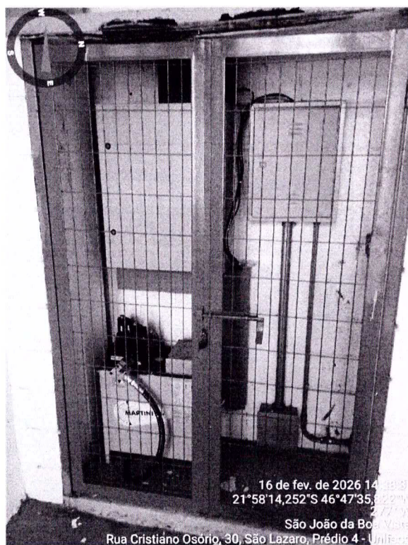
07 - Foto do comando do elevador, corredor externo.
